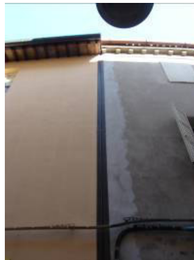
Figura 5.28 Rione rosso (R.06), giunto di separazione tra due edifici affiancati.
