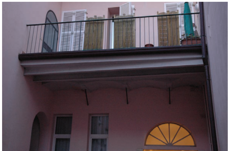
Figura 4.5 Balcone in voltine con ampliamento sostenuto da putrelle di ferro (p.lla 118).
