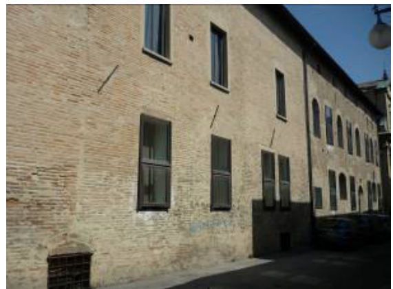
Figura 5.77 Incatenamento al livello del solaio intermedio.
