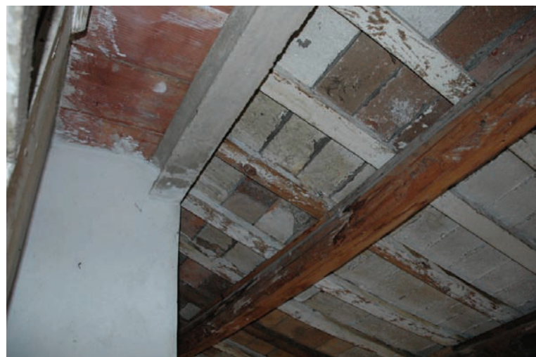
Figura 4.2 Intervento recente con putrelle prefabbricate di calcestruzzo su solaio tradizionale di legno (p.lla 110).
