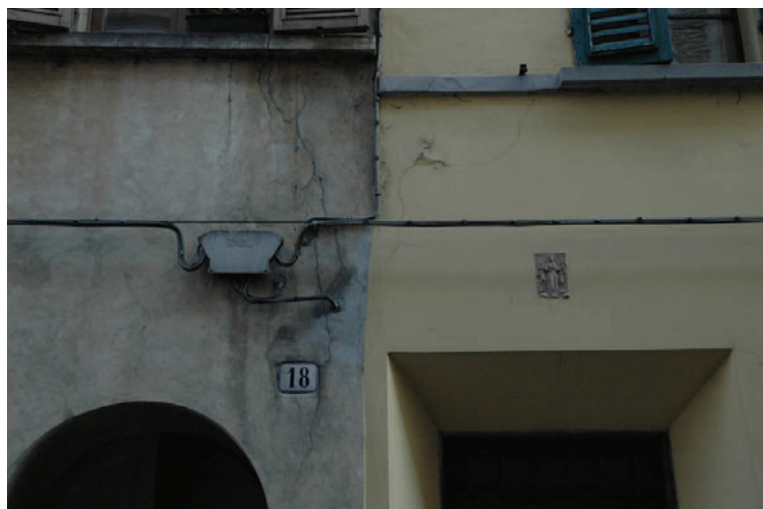
Figura 3.6 Lesioni diffuse sulla connessione tra fabbricati adiacenti (p.lle 125 e 126).
